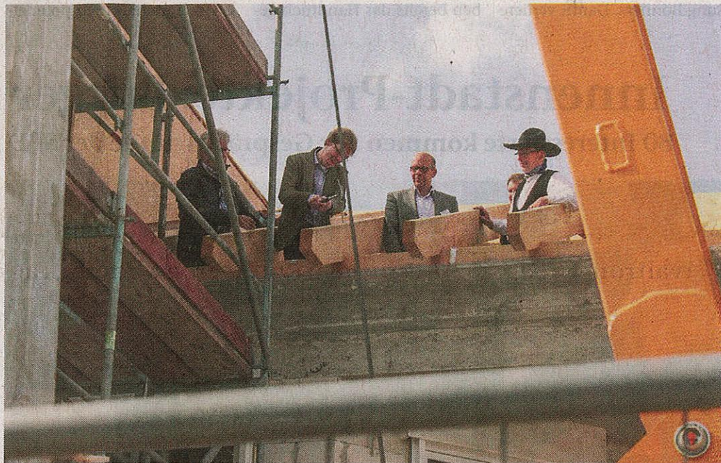
Der spätere Bewohner des Lebenshilfe-Wohnhauses Jannik Bergmann schlug den symbolisch letzten Nagel ins Dach des Rohbaus an der Möllerstraße.
